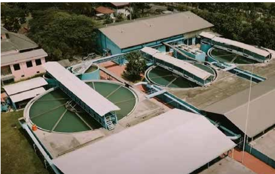
Instalasi Pengolahan Air PT Jababeka Infrastruktur Water Treatment Plant PT Jababeka Infrastruktur
